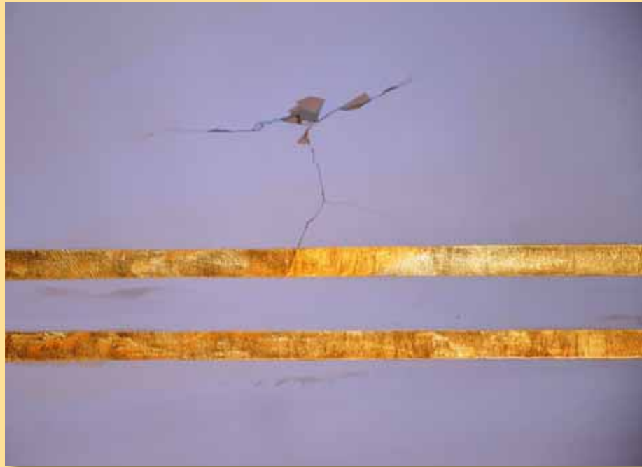
Deckenschaden in der Apsis
